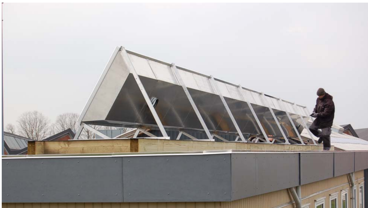
14 m2 system at Den jyske Håndværkerskole (Technical school in Hadsten, Denmark)
